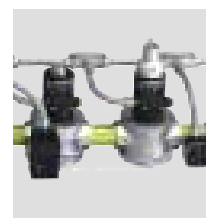
Tuyauterie et câblage aux normes américaines
