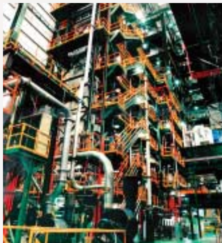
Installation de galvanisation Société Electric-Fumace
