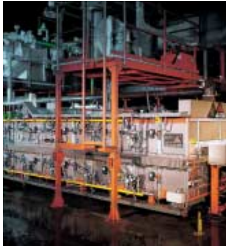
Four de chauffe Société Heimsoth
