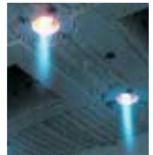
Chauffage en voûte avec brûleur BIC
