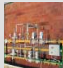
Ligne de gaz
